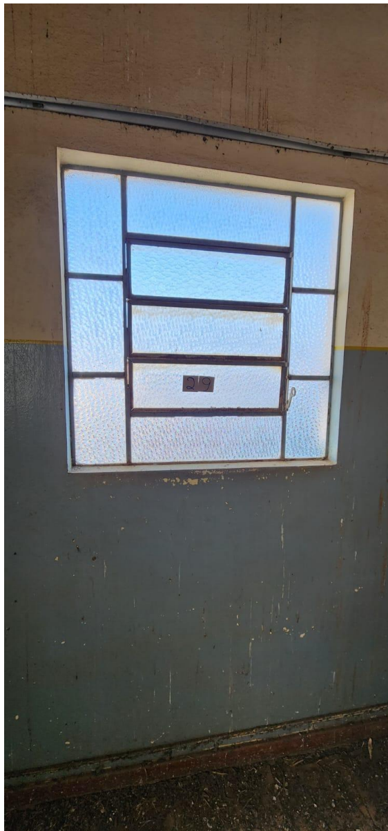
FOTO 51– SALA 08 – CAXILHO J29 DANIFICADA E PINTURA DETERIORADA
