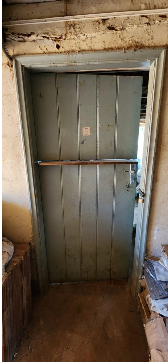
FOTO 14 – SALA 05 – CAXILHO P05 DANIFICADA, TRINCO ESTRAGADO E PINTURA DETERIORADA
