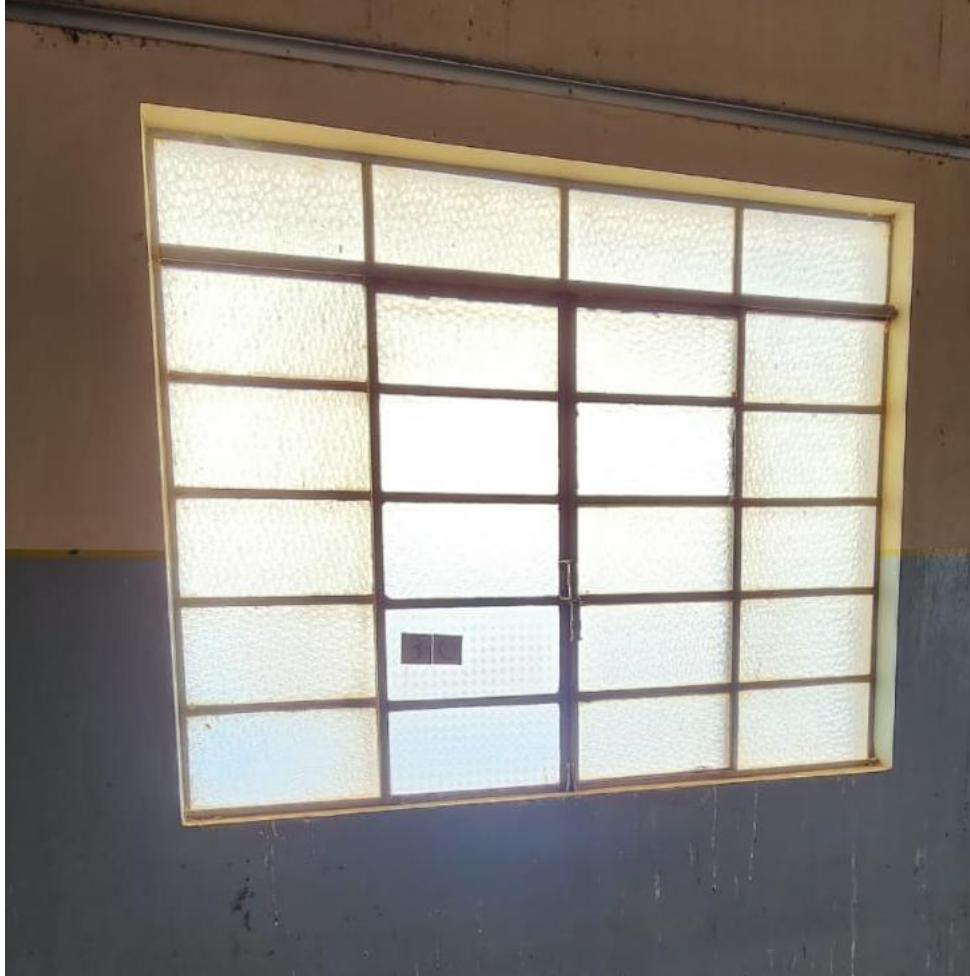
FOTO 50 – SALA 08 – CAXILHO J30 DANIFICADA E PINTURA DETERIORADA
