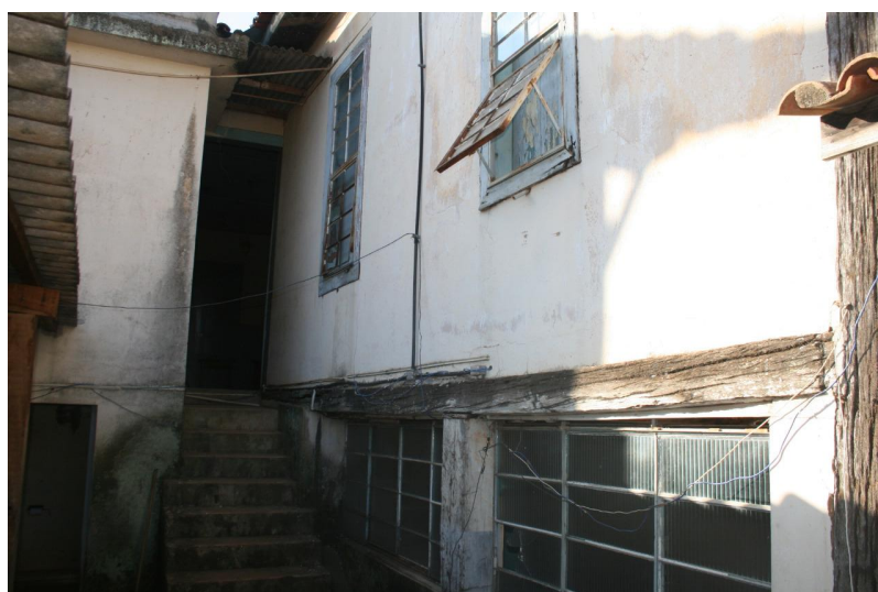
FOTO 63– FACHADA LATERAL - FIAÇÃO EXPOSTA, PINTURA DETERIORADA, CAIXILHO ENFERRUJADO E VIDRO QUEBRADO
