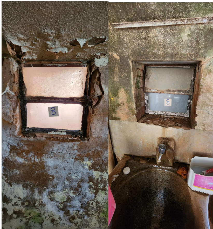
FOTO 30 – BANHEIRO – CAXILHO J08 DANIFICADA, AUSENCIA DE TRINCO DE FECHAMENTO E PINTURA DETERIORADA
