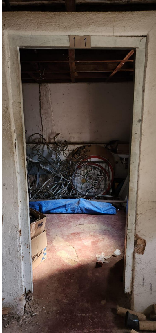
FOTO 23 – SALÃO 01 – CAXILHO P11 DANIFICADA, PORTAL CORROIDO POR CUPINS E PINTURA DETERIORADA
