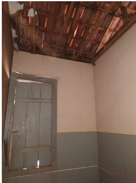
FOTO 73 – SALA 07 - FIAÇÃO EXPOSTA, CAIXILHOS DANIFICADOS E PINTURA DETERIORADA
