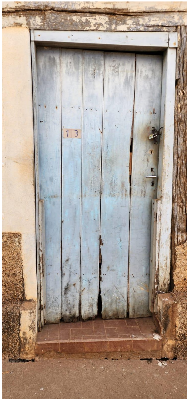
FOTO 28 – SALA 04 – CAXILHO J15 DANIFICADA POR ATAQUE DE CUPINS, EXPOSIÇÃO A INTEMPÉRIES CLIMÁTICAS, MAÇANETA ESTRAGADA E PINTURA DETERIORADA
