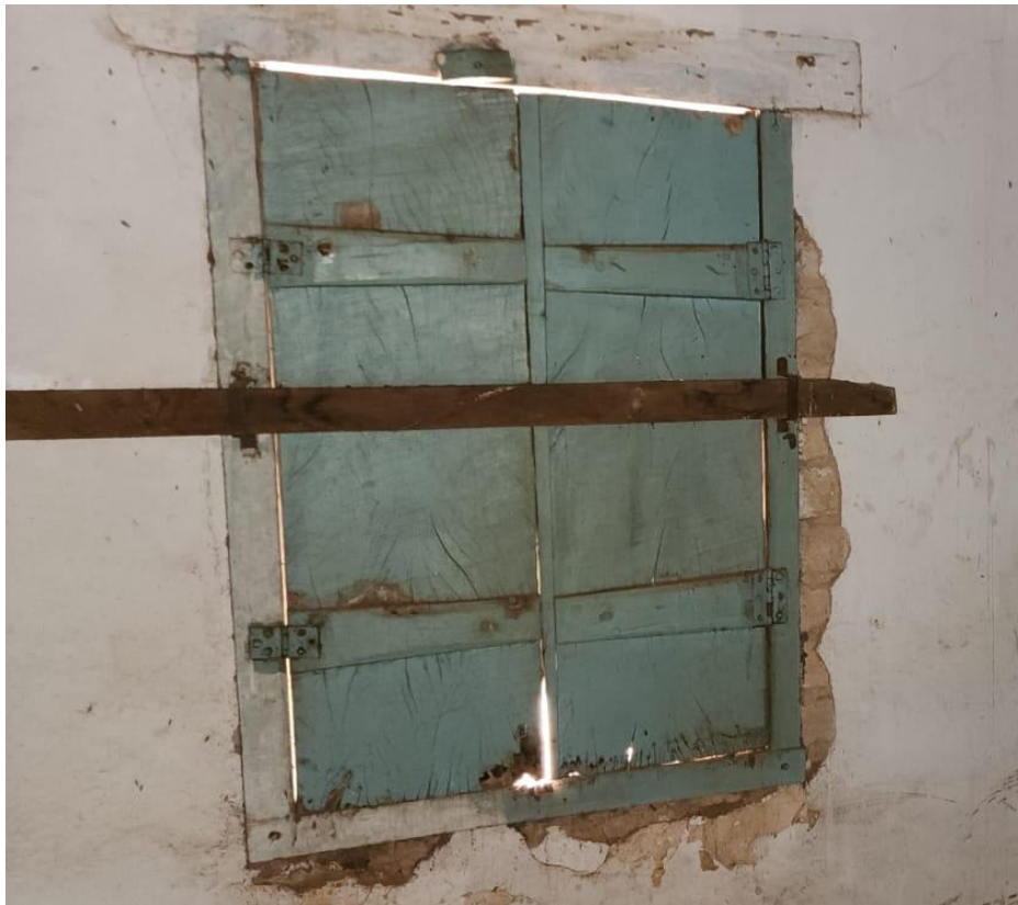
FOTO 24 – SALA 03 – CAXILHO J13 DANIFICADA, CORROIDA POR CUPINS, AUSÊNCIA DE TRAVAMENTO DE MADEIRA PARA O SEU FECHAMENTO E PINTURA DETERIORADA
