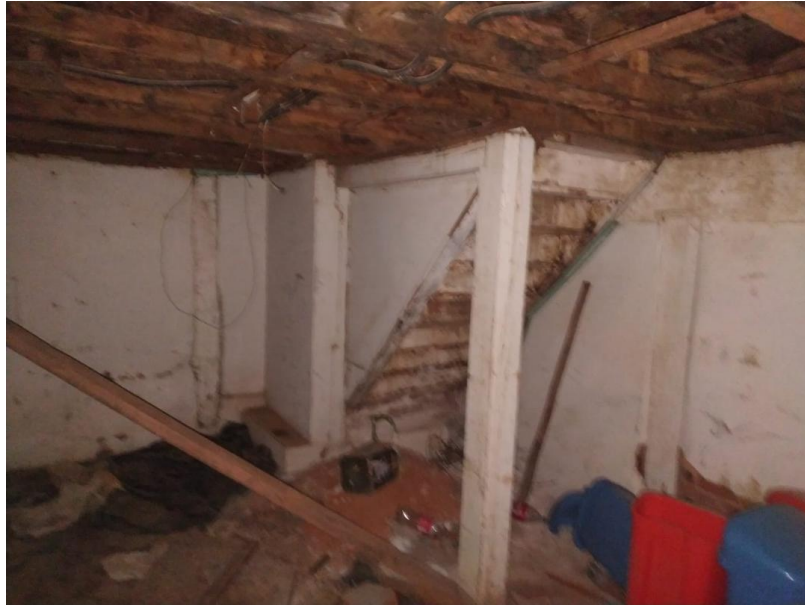
FOTO 68 – SALA 03 - AUSENCIA DE FORRO, INFILTRAÇÃO NAS PAREDES, PINTURA DETERIORADA E PISO DANIFICADO
