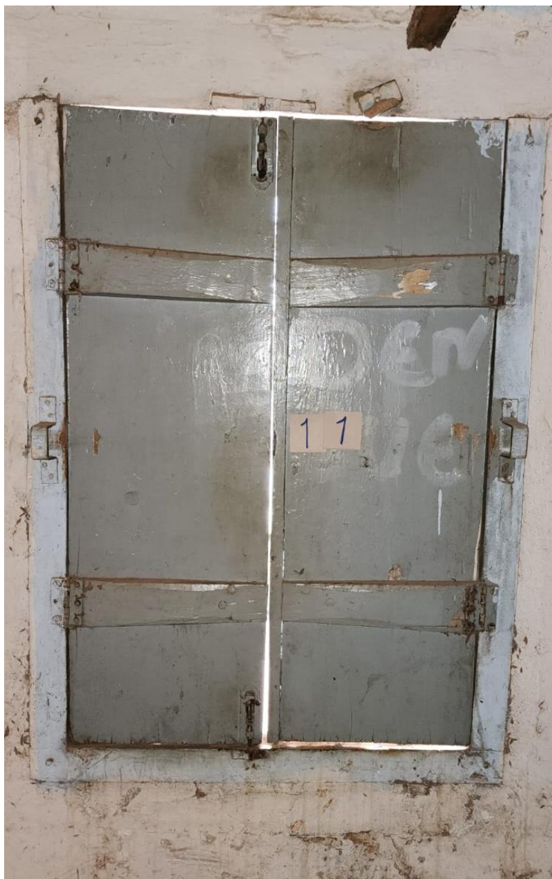
FOTO 19 – SALÃO 01 – CAXILHO J11 DANIFICADA E PINTURA DETERIORADA
