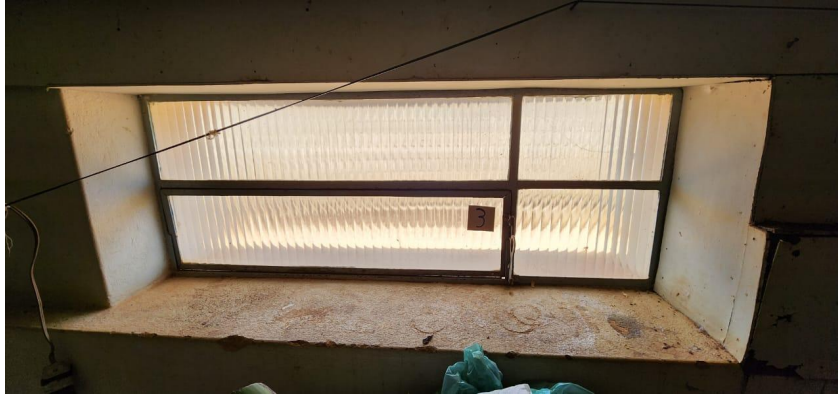
FOTO 8 – SALA 05 – CAXILHO J03 - PINTURA DETERIORADA
