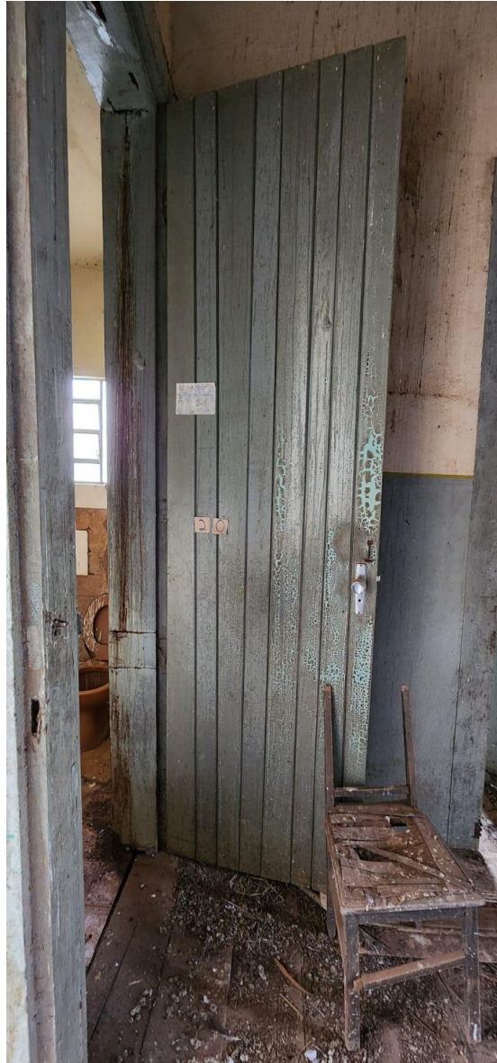
FOTO 32 – SALÃO 03 – CAXILHO P20 DANIFICADA, MAÇANETA ESTRAGADA, CORROIDA POR CUPINS E PINTURA DETERIORADA
