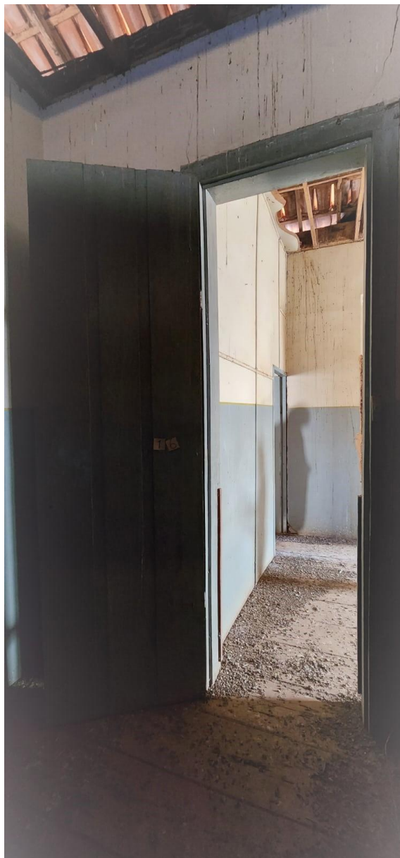
FOTO 38 – SALÃO 03 – CAXILHO P16 DANIFICADA E PINTURA DETERIORADA
