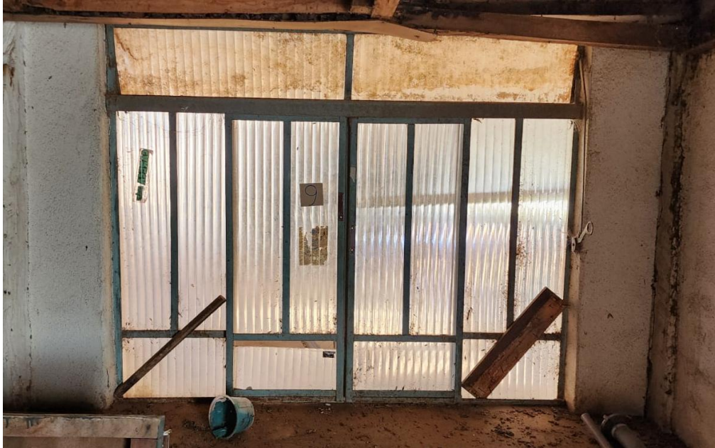
FOTO 17 – SALÃO 02 – CAXILHO J09 DANIFICADA, AUSÊNCIA DE TRINCO, VIDRO QUEBRADO E PINTURA DETERIORADA
