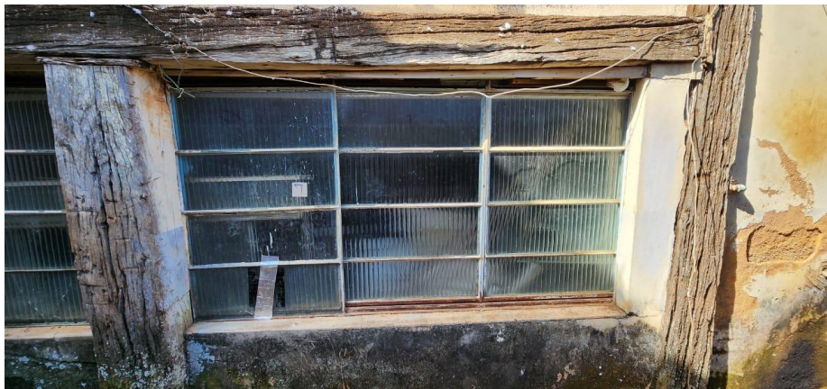
FOTO 12 – SALA 05 – CAXILHO J07 DANIFICADA, APRESENTA VIDRO QUEBRADO, AUSENCIA DE FECHAMENTO SUPERIOR E PINTURA DETERIORADA
