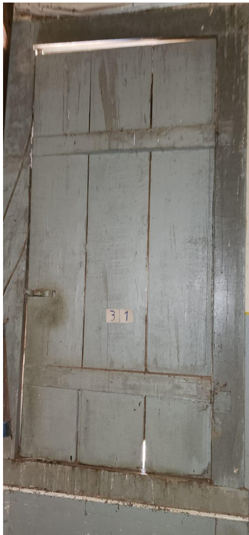
FOTO 49 – SALA 07 – CAXILHO J31 DANIFICADA E PINTURA DETERIORADA
