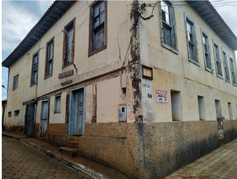
FOTO 60 – FACHADA FRONTAL E LATERAL - PROBLEMA ESTRUTURAL TRINCA, FIAÇÃO EXPOSTA, CAXILHOS DANIFICADOS E PINTURA DETERIORADA
