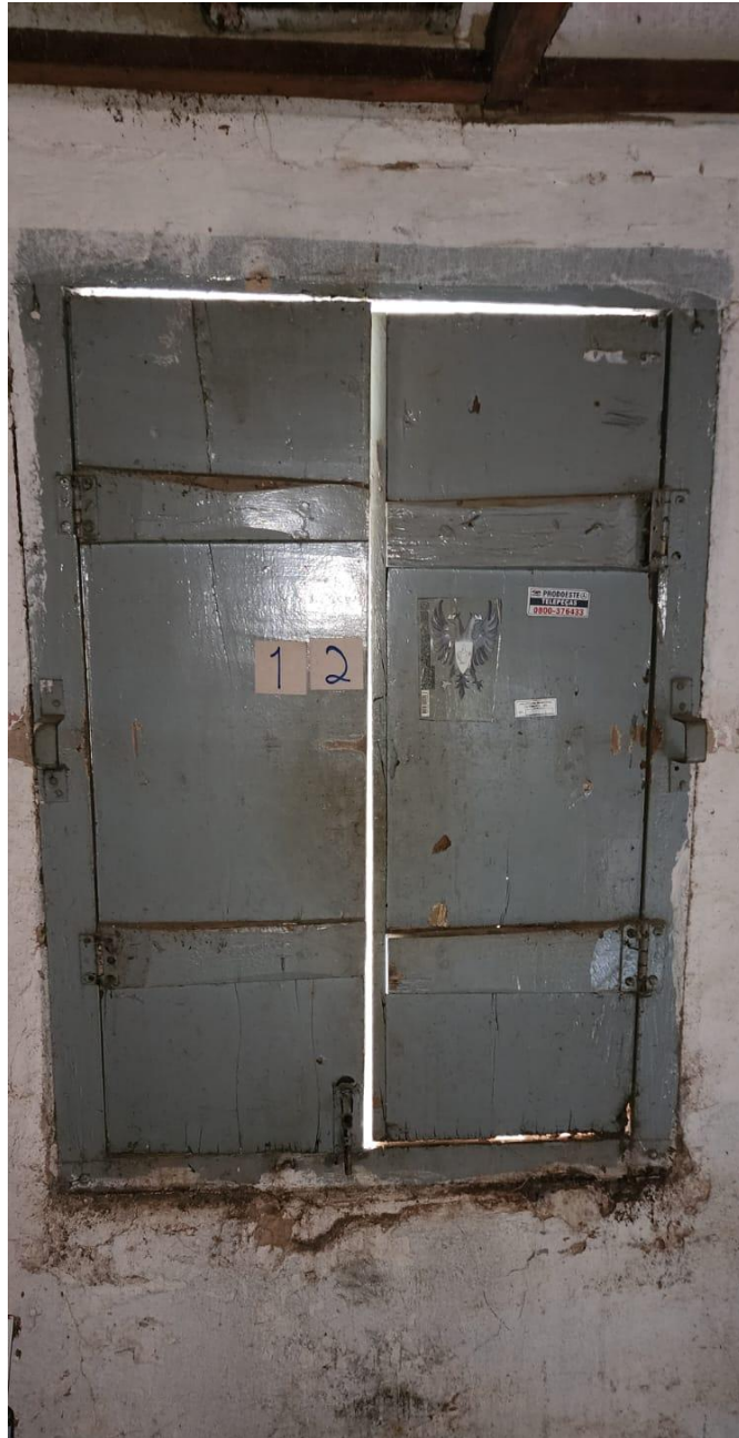
FOTO 20 – SALA 02 – CAXILHO J12 DANIFICADA, CORROIDA POR CUPINS, TRINCO ESTRAGADO E PINTURA DETERIORADA
