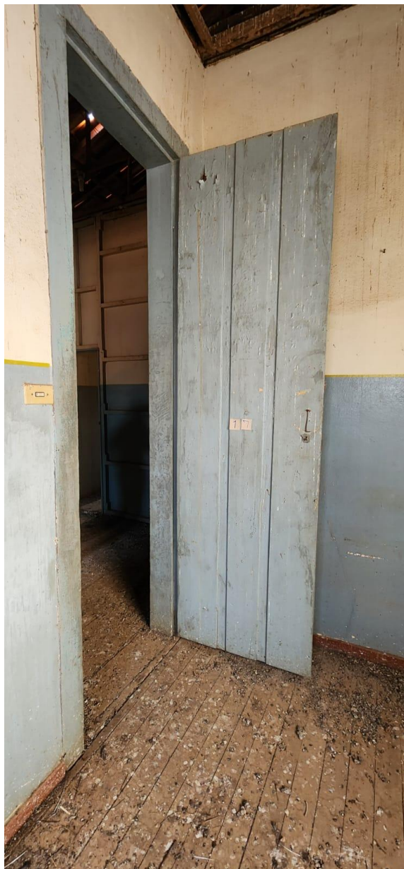
FOTO 39 – SALÃO 03 – CAXILHO P17 DANIFICADA, AUSENCIA DE CHAVE PARA FECHAMENTO E PINTURA DETERIORADA
