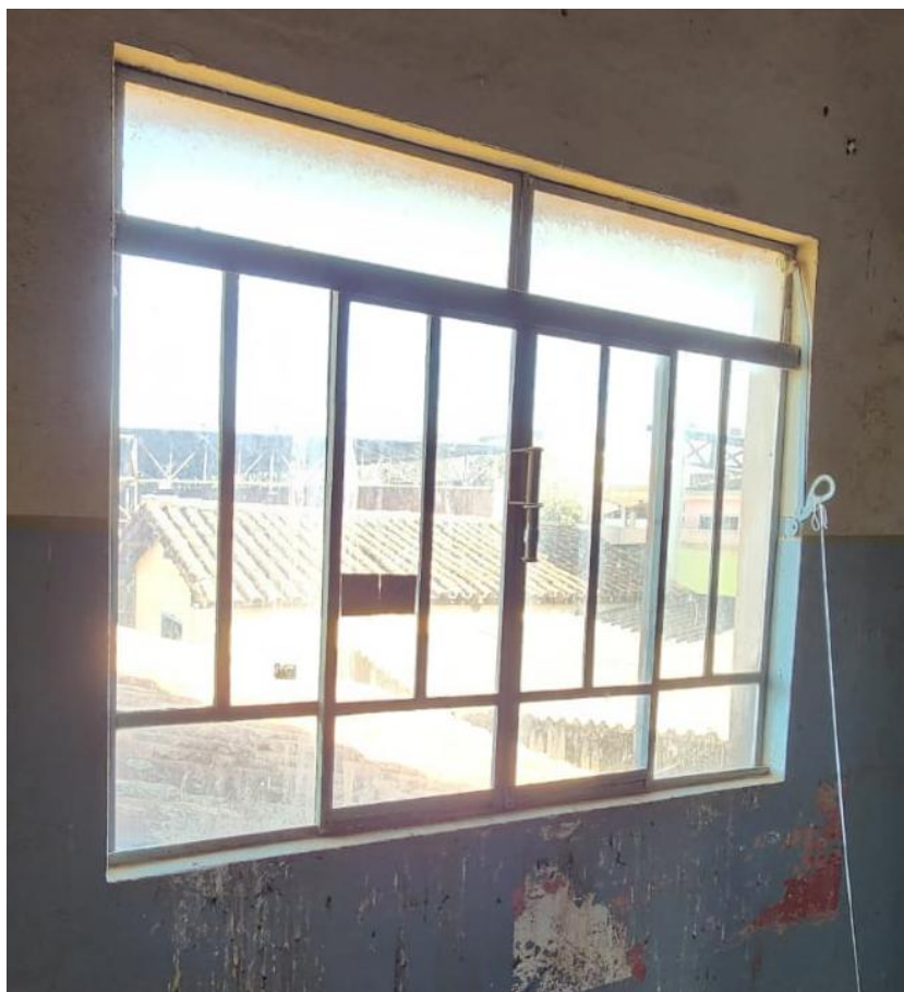
FOTO 52– SALA 09 – CAXILHO J28 DANIFICADA E PINTURA DETERIORADA
