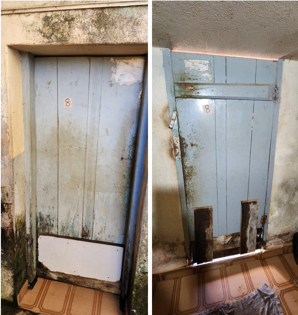
FOTO 29 – BANHEIRO – CAXILHO P08 DANIFICADA POR ATAQUE DE CUPINS, EXPOSIÇÃO A INTEMPÉRIES CLIMÁTICAS, AUSÊNCIA DE MAÇANETA E PINTURA DETERIORADA
