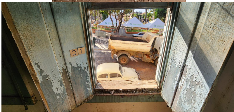
FOTO 43 – SALA 11 – CAXILHO J22 E J21 DANIFICADA E PINTURA DETERIORADA
