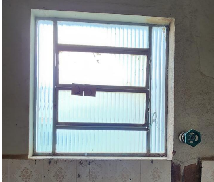
FOTO 41 – W.C. – CAXILHO J25 DANIFICADA, VIDRO TRINCADO E PINTURA DETERIORADA
