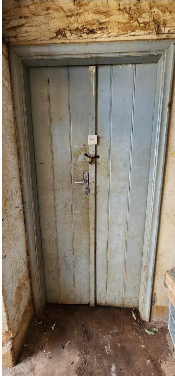
FOTO 13 – SALA 05 – CAXILHO P04 DANIFICADA, MAÇANETA ESTRAGADA E PINTURA DETERIORADA
