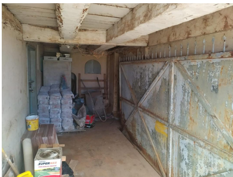
FOTO 65 – HALL - PINTURA DA PAREDE DETERIORADA, CAIXILHOS DANIFICADOS E FIAÇÃO EXPOSTA
