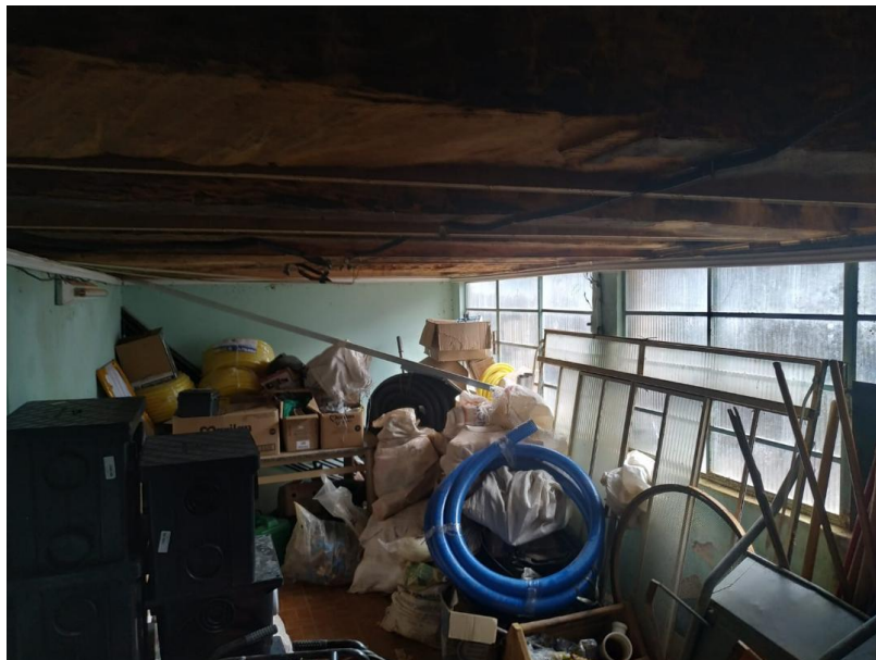
FOTO 69 – SALA 05 - AUSENCIA DE FORRO, INFILTRAÇÃO NAS PAREDES, PINTURA DETERIORADA E FIAÇÃO EXPOSTA
