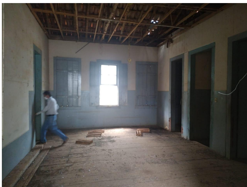
FOTO 71 – SALÃO 03 - FIAÇÃO EXPOSTA, CAIXILHOS DANIFICADOS, PINTURA DETERIORADA, TELHADO COM INFILTRAÇÃO, AUSÊNCIA DE FORRO E ASSOALHO DANIFICADO
