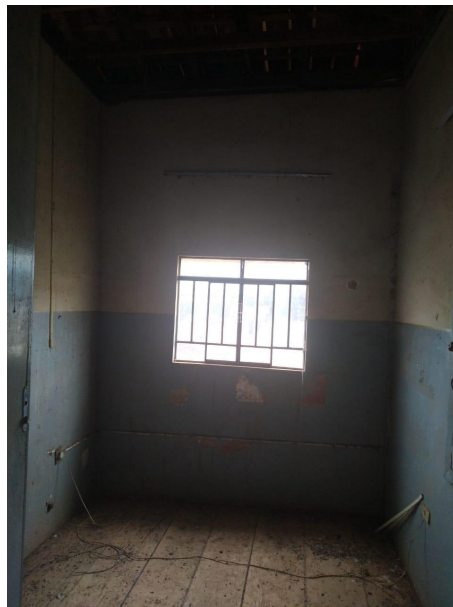
FOTO 75 – SALA 09 - FIAÇÃO EXPOSTA, ASSOALHO DANIFICADO, AUSENCIA DE FORRO E PINTURA DETERIORADA
