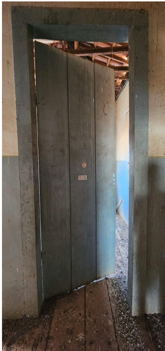
FOTO 40 – SALÃO 03 – CAXILHO P18 DANIFICADA, AUSENCIA DE MAÇANETA E PINTURA DETERIORADA
