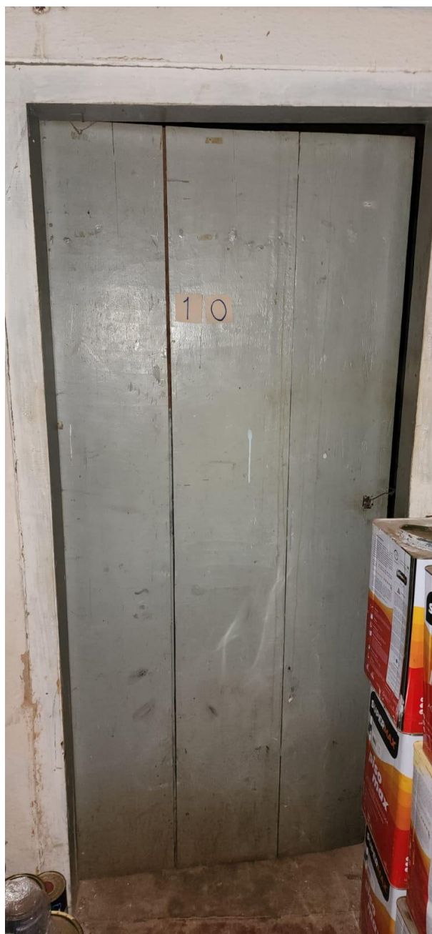
FOTO 22 – SALÃO 01 – CAXILHO P10 DANIFICADA, AUSÊNCIA DE TRINCO E PINTURA DETERIORADA
