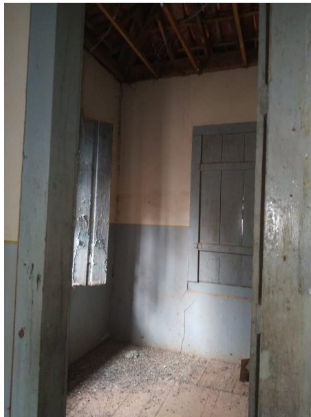
FOTO 76 – SALA 10 – AUSENCIA DE FORRO, PINTURA DETERIORADA, TRINCA ENTRE A JUNÇÃO DAS PAREDES E ABAIXO DA JANELA, ASSOALHO E CAXILHOS DANIFICADOS
