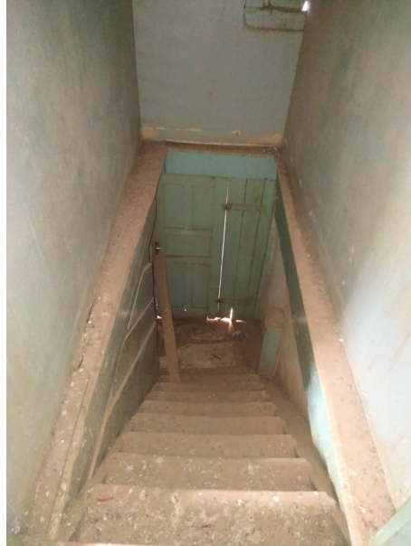
FOTO 78 – ESCADA - PAREDE COM PINTURA DETERIORADA, CAXILHOS E PISOS DANIFICADOS E FIAÇÃO EXPOSTA
