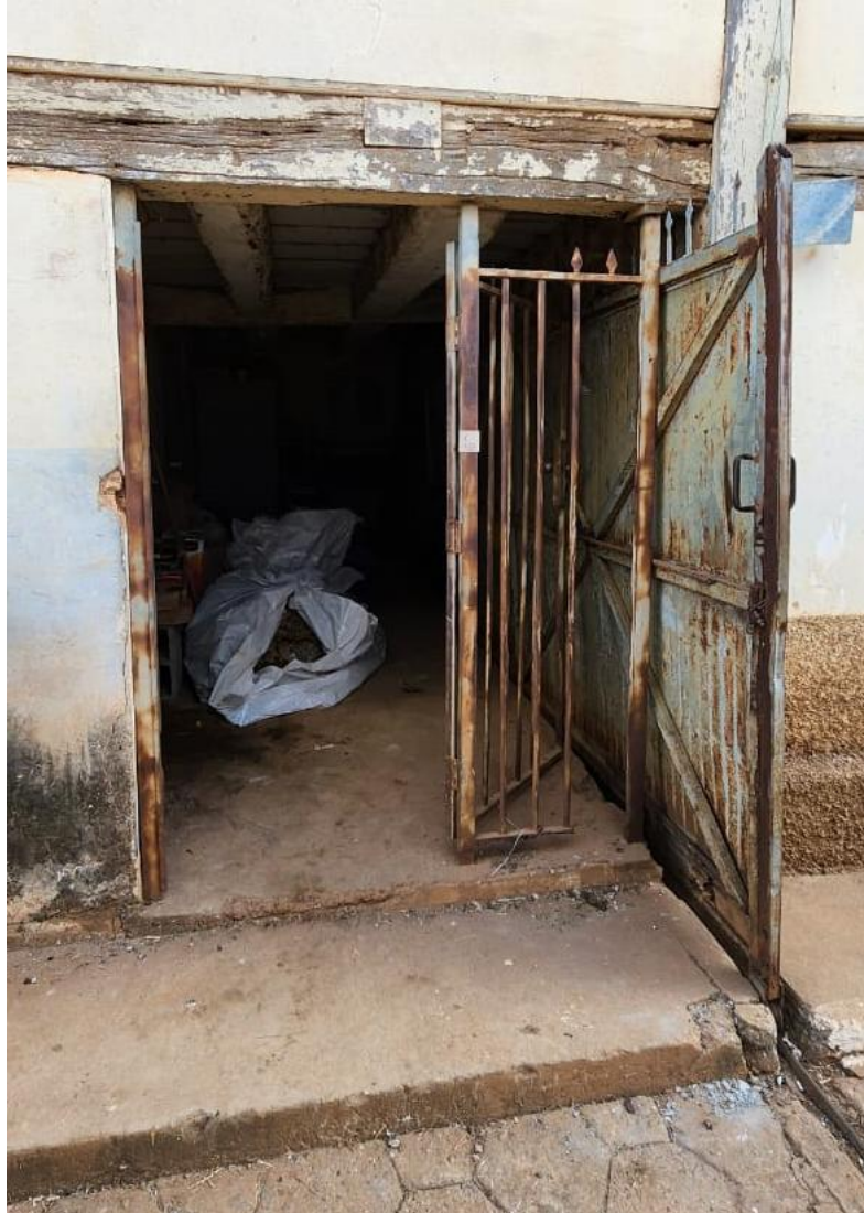
FOTO 15 – HALL – CAXILHO P06 DANIFICADA, AUSENCIA DE PEÇAS DE METALON NA ESTRUTURA DO PORTÃO E PINTURA DETERIORADA
