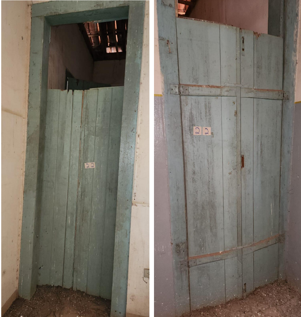
FOTO 34 – SALA 11 – CAXILHO P22 DANIFICADA, CORROIDA POR CUPINS, AUSENCIA DA BANDEIRA E TRINCO DE FECHAMENTO E PINTURA DETERIORADA
