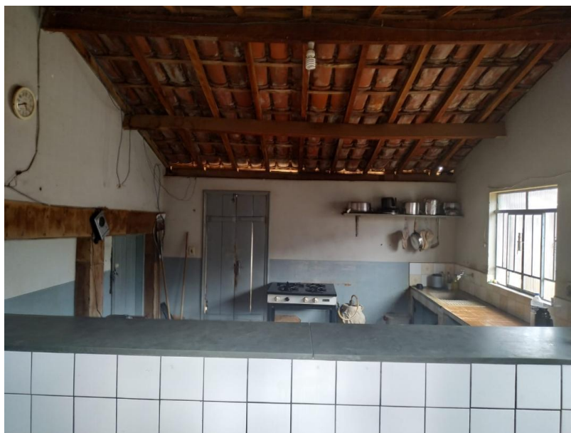
FOTO 64 – COZINHA - FIAÇÃO EXPOSTA, CAIXILHOS DANIFICADOS, AUSENCIA DE FORRO E PINTURA DETERIORADA
