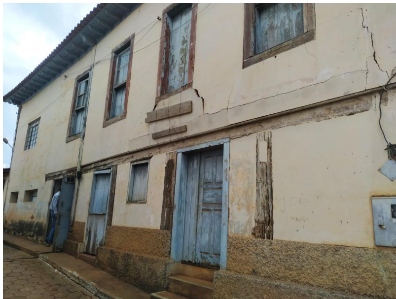
FOTO 61 – FACHADA LATERAL - PROBLEMA ESTRUTURAL TRINCA, FIAÇÃO EXPOSTA, CAXILHOS DANIFICADOS E PINTURA DETERIORADA
