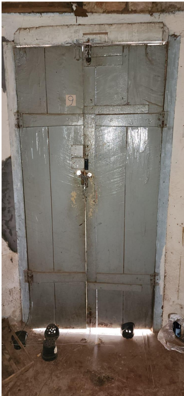
FOTO 21 – SALÃO 01 – CAXILHO P09 DANIFICADA, AUSENCIA DE CHAVE NA FECHADURA E PINTURA DETERIORADA
