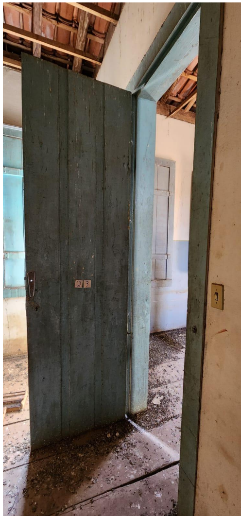
FOTO 35 – SALA 11 – CAXILHO P23 DANIFICADA, AUSENCIA DE TRINCO DE FECHAMENTO E PINTURA DETERIORADA
