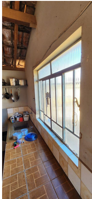
FOTO 1 – COZINHA – CAXILHO J01 DANIFICADA, VIDRO QUEBRADO, TRINCO E PINTURA DETERIORADA
