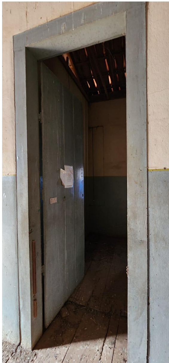
FOTO 37 – SALÃO 03 – CAXILHO P15 DANIFICADA, AUSENCIA DE MAÇANETA E PINTURA DETERIORADA
