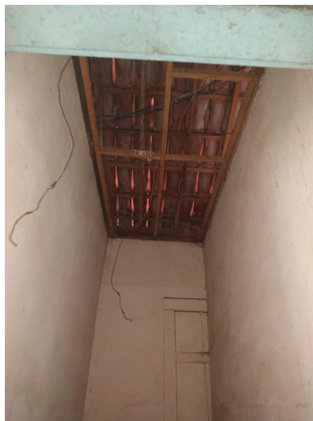
FOTO 79 – ESCADA – AUSENCIA DE FORRO, PAREDE COM PINTURA DETERIORADA E FIAÇÃO EXPOSTA
