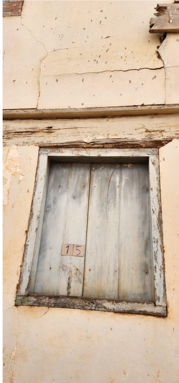
FOTO 27 – SALA 04 – CAXILHO J15 DANIFICADA E PINTURA DETERIORADA
