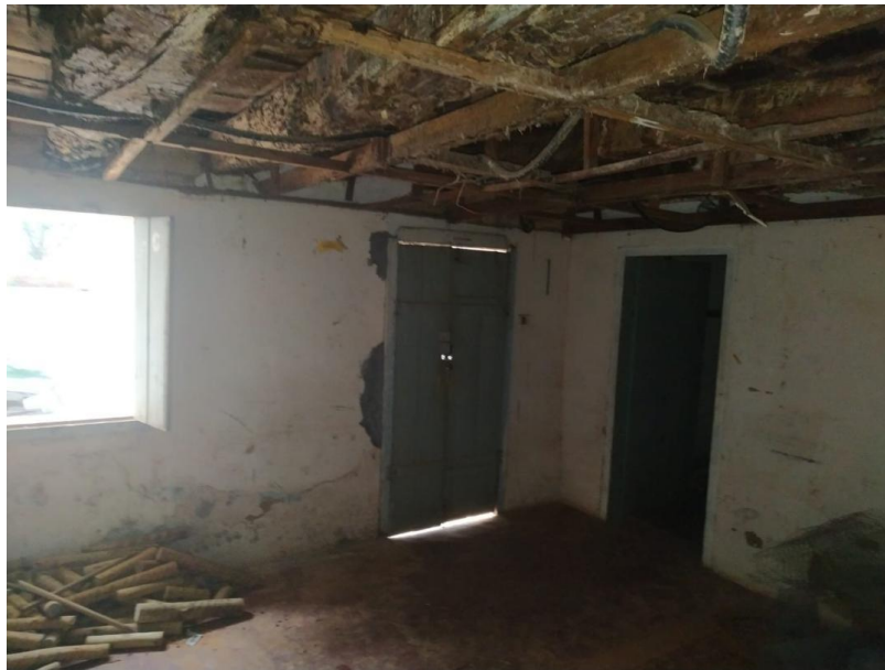
FOTO 66 – SALÃO 01 - AUSENCIA DE FORRO, INFILTRAÇÃO NAS PAREDES, PINTURA DETERIORADA E PISO DANIFICADO
