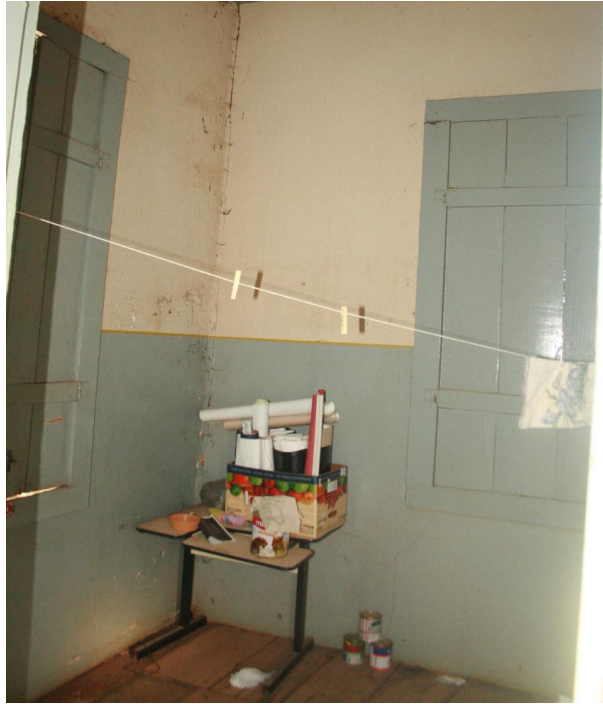
FOTO 72 – SALA 06 - JUNÇÃO DAS PAREDES E ABAIXO DA JANELA APRESENTA TRINCA, PINTURA DETERIORADA E ASSOALHO DANIFICADO
