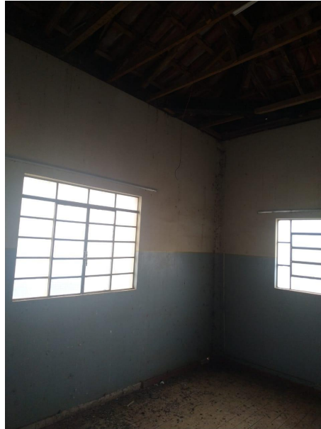
FOTO 74 – SALA 08 - FIAÇÃO EXPOSTA, ASSOALHO E RODAPÉ DANIFICADOS, AUSENCIA DE FORRO, E PINTURA DETERIORADA
