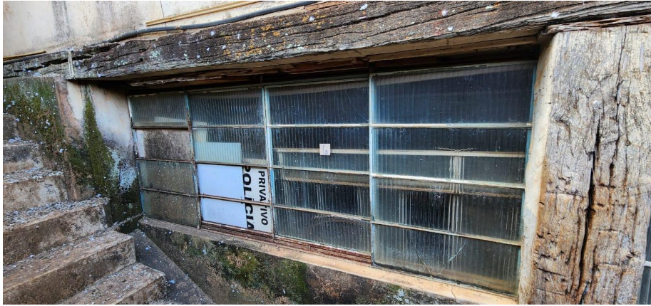
FOTO 11 – SALA 05 – CAXILHO J06 DANIFICADA, AUSENCIA DE PARTES DOS VIDROS, APRESENTA VIDROS TRINCADOS E PINTURA DETERIORADA
