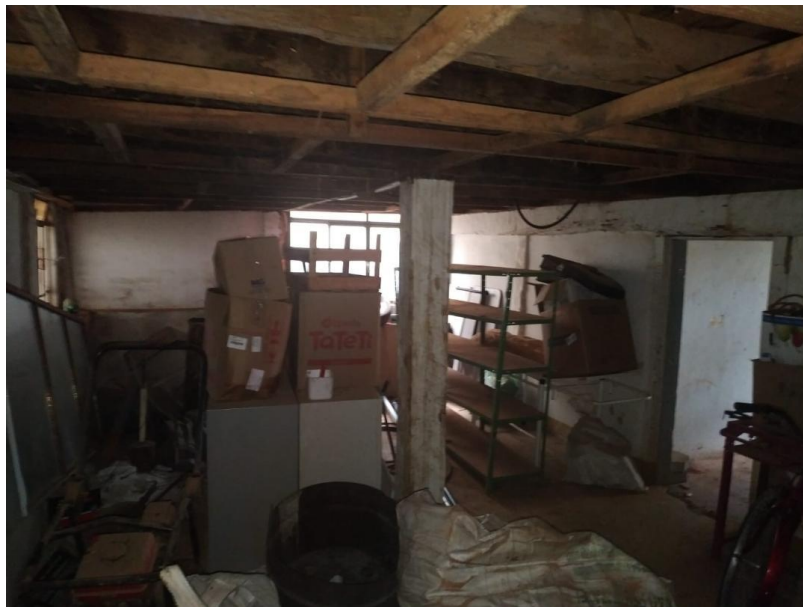
FOTO 67 – SALÃO 02 - AUSENCIA DE FORRO, INFILTRAÇÃO NAS PAREDES, PINTURA DETERIORADA E PISO DANIFICADO
