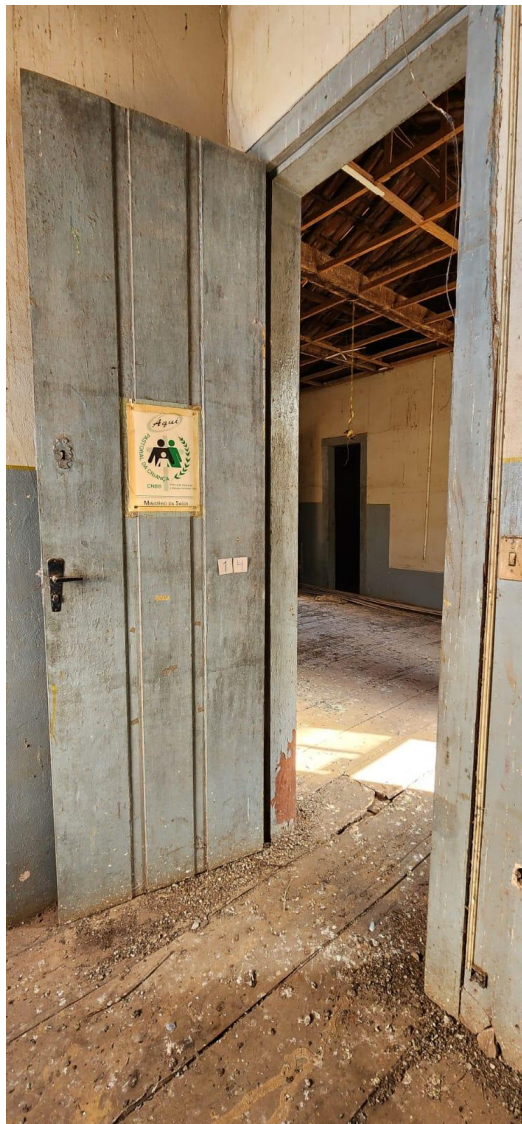
FOTO 36 – SALA 06 – CAXILHO P14 DANIFICADA E PINTURA DETERIORADA
