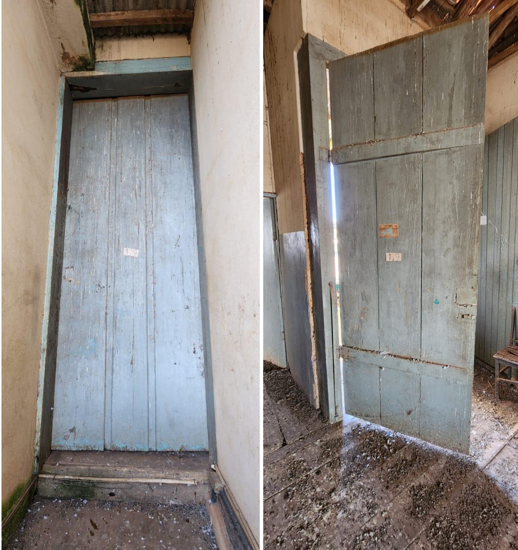
FOTO 31 – SALÃO 03 – CAXILHO P19 DANIFICADA E PINTURA DETERIORADA
