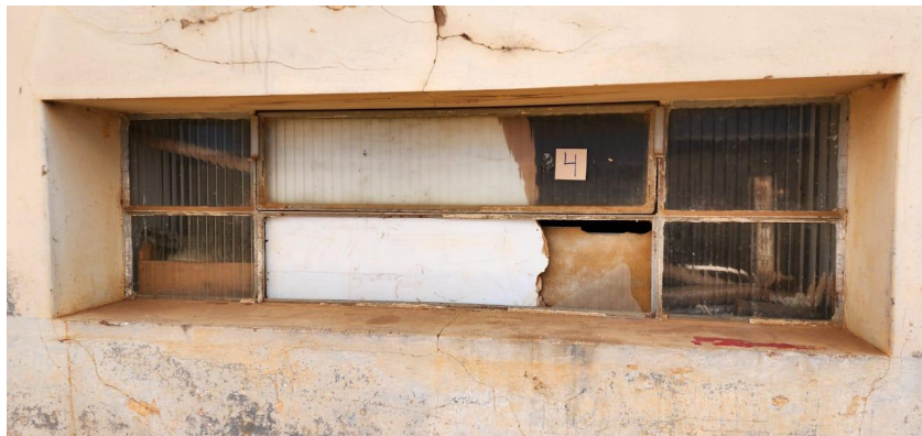
FOTO 9 – SALA 05 – CAXILHO J04 - DANIFICADA, AUSENCIA DE PARTE DO VIDRO E PINTURA DETERIORADA
