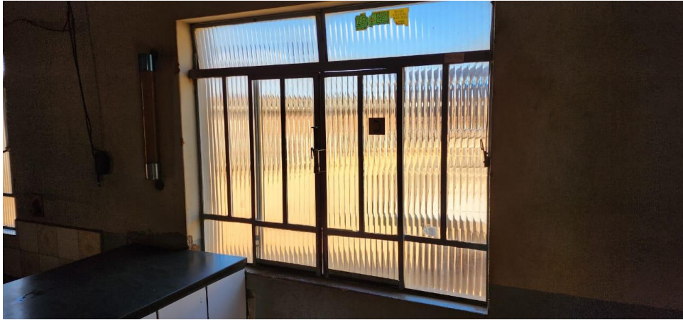
FOTO 3 – COZINHA – CAXILHO J02 DANIFICADA, TRINCO E PINTURA DETERIORADA
