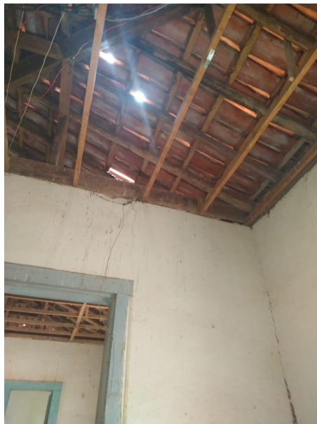
FOTO 77 – SALA 11- AUSENCIA DE FORRO, TELHADO COM INFILTRAÇÃO, JUNÇÃO DAS PAREDES COM TRINCA E PINTURA DETERIORADA
