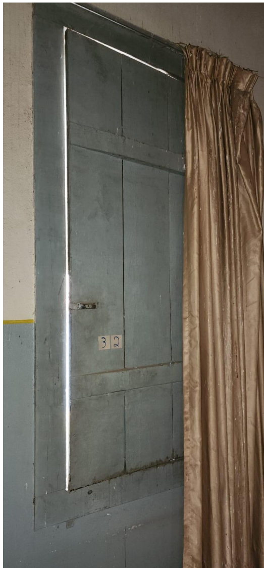
FOTO 48 – SALA 07 – CAXILHO J32 DANIFICADA E PINTURA DETERIORADA
