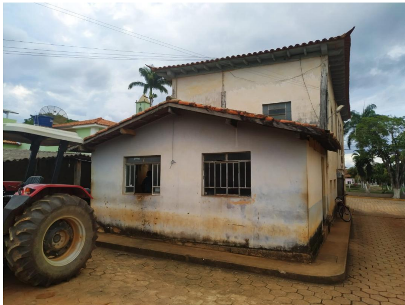
FOTO 62 – FACHADA FUNDO - FIAÇÃO EXPOSTA E PINTURA DETERIORADA
