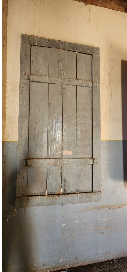
FOTO 45 – SALÃO 03 – CAXILHO J20 DANIFICADA E PINTURA DETERIORADA
